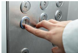
エレベーター
